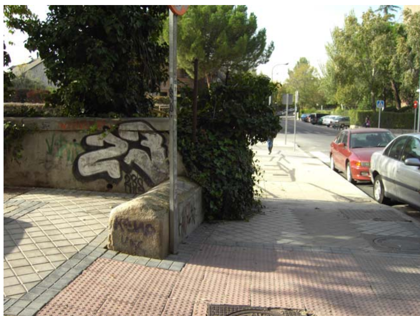
Foto 16. Emplazamiento del álamo chino que aparece con el número en el inventario. Al crecer sobreelevado, la presión ejercida por las raíces puede ocasionar daños en la obra de fábrica en un futuro no muy lejano.
